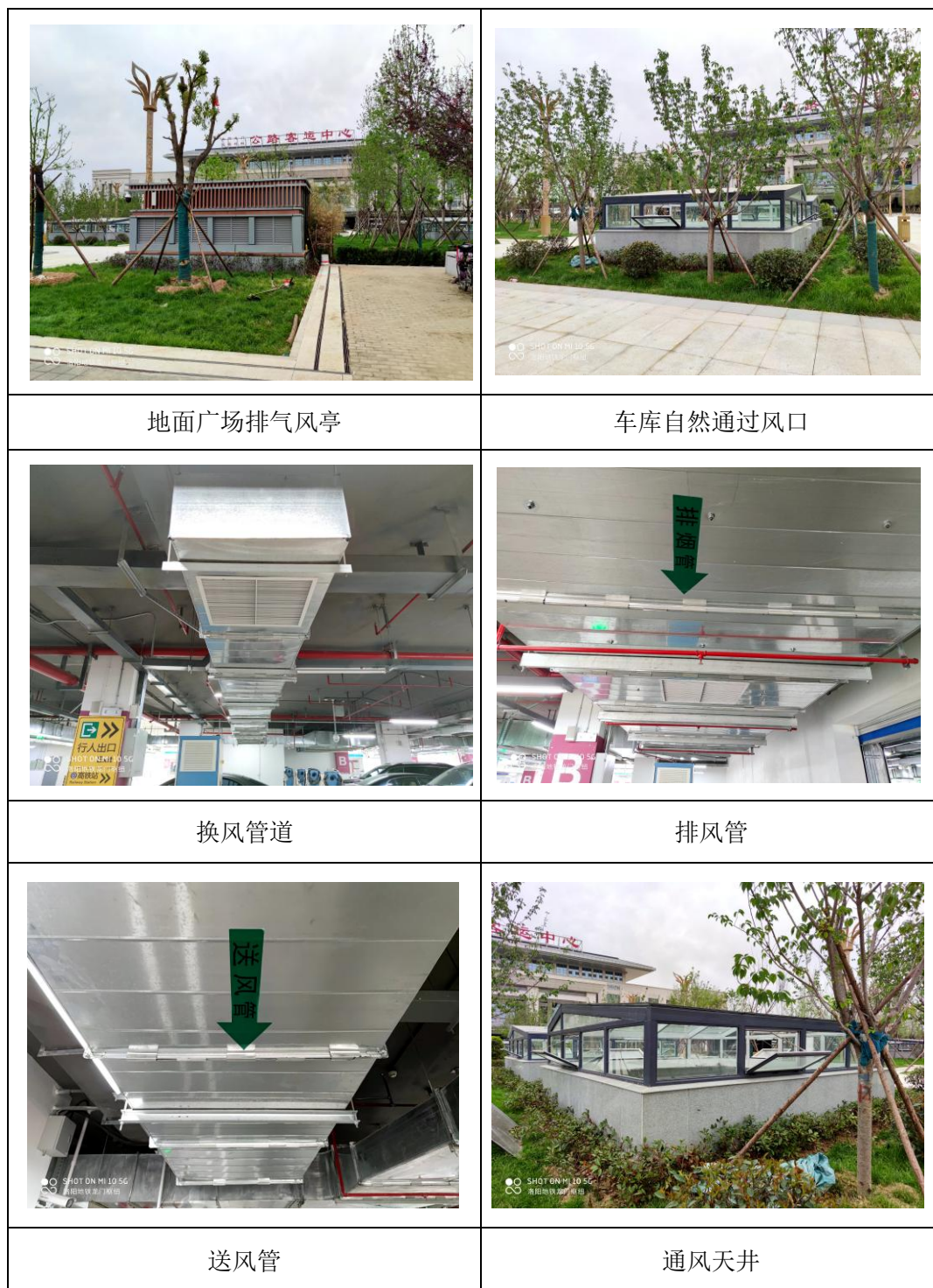
图 8.3-1 车库内通排风系统
